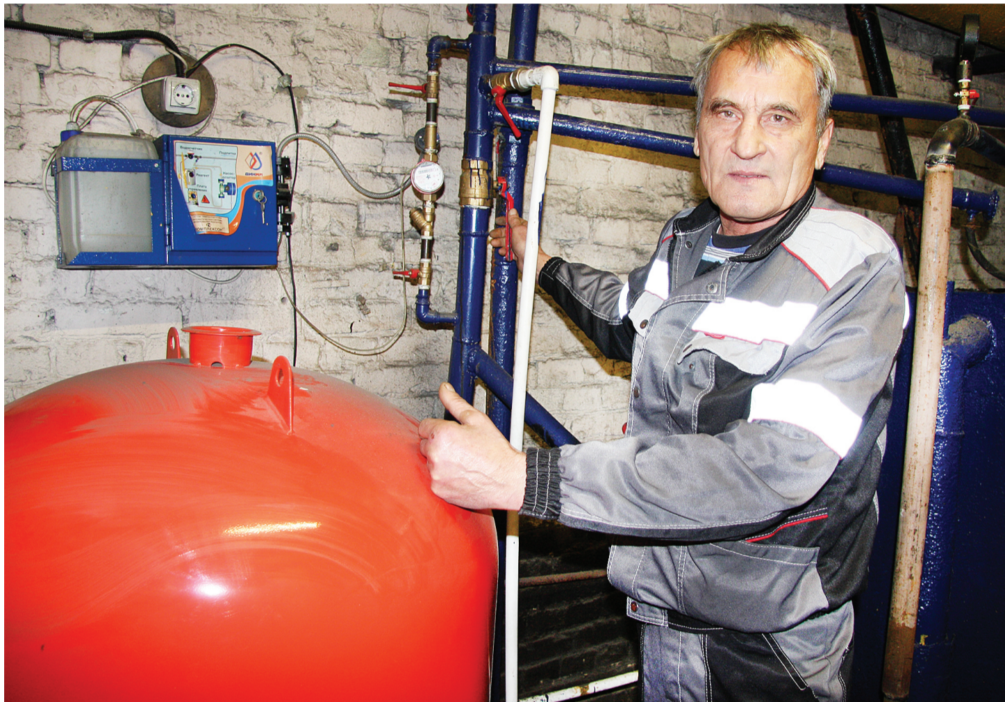
Очень рад новому оборудованию мастер Боголюбовской котельной Анатолий Клюков.
