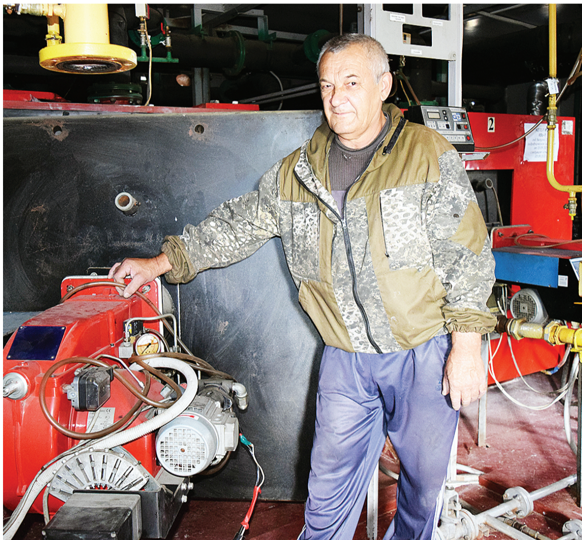
Слесарь Конзаводской котельной Николай Битехтин.
