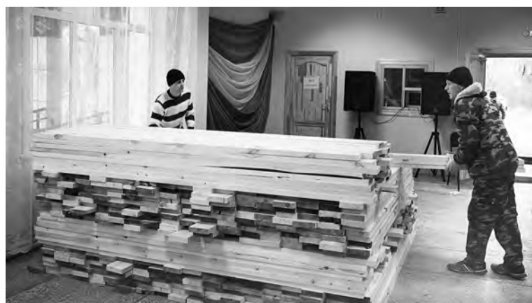
Ремонт Дома культуры в поселке Москаленский занимается местная бригада строителей по руководством В. К. Долгова.
